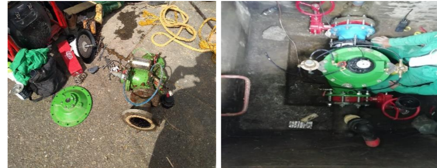
Fotografías: Optimización estación sector hidráulico 17
